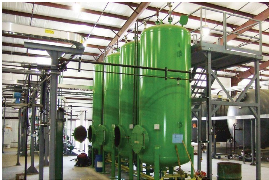
Retrofit de Sistema de Troca Iônica
